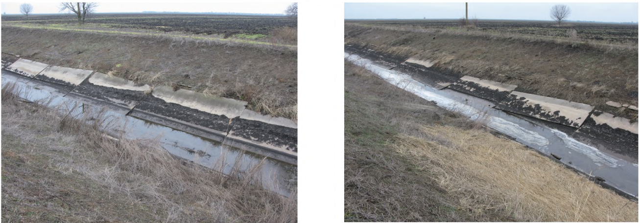
Рис. 4. Технічний стан МК-2 на ділянці ПК33+00-34+00
