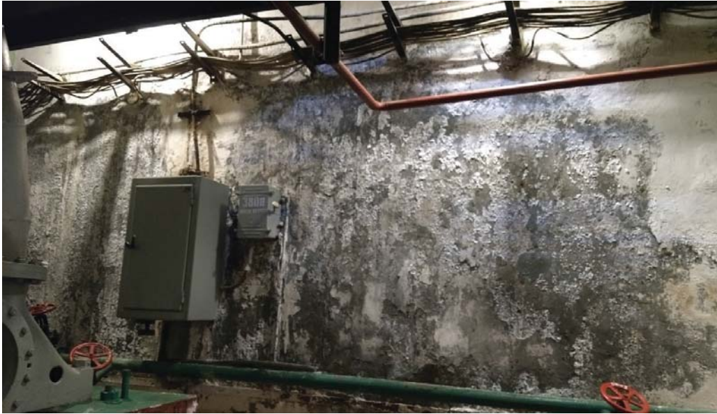
Рис. 1. Фільтрація води через конструкцію стіни докової частини насосної станції «Конча-Заспа-Плюти»
