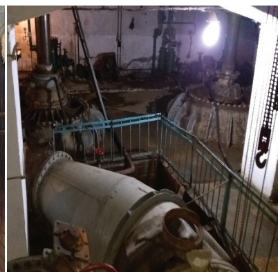
Рис. 3. Технічний стан Головної насосної станції в Одеській області
