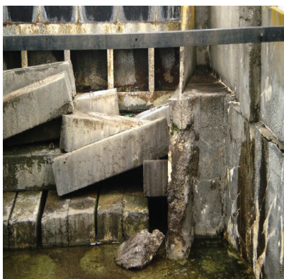
Рис. 1. Стан залізобетонних конструкцій аварійного полігонального водоскиду в Херсонській області
