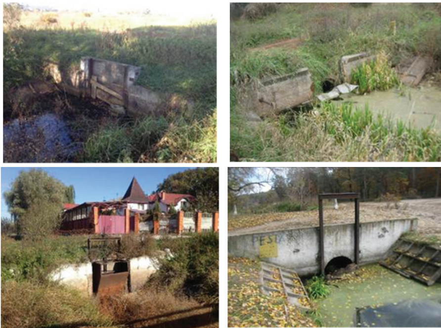
Рис. 4. Стан водорегулювальних гідротехнічних споруд на каналах Ірпінської ОЗС (2018 р., фото А.М. Шевченка)
