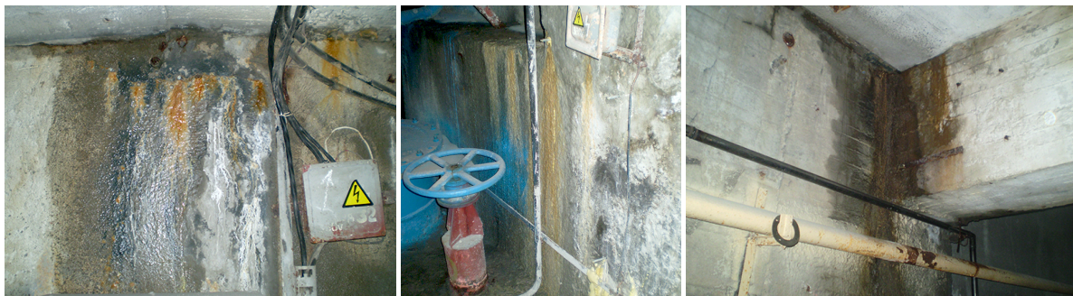
Рис. 2. Місця фільтрації води усередину споруди
