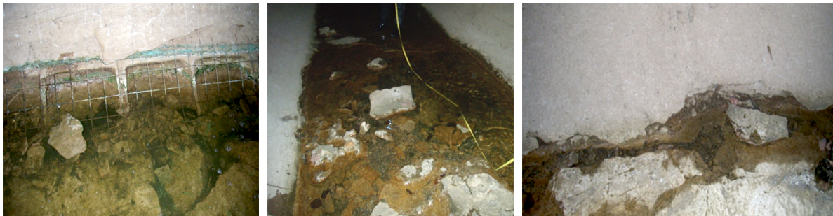
Рис. 3. Характерні дефекти гідротехнічного тунелю № 1
