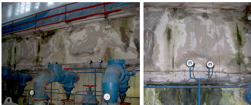
Рис. 4. Протічки в доковій частині Кочурської насосної станції
